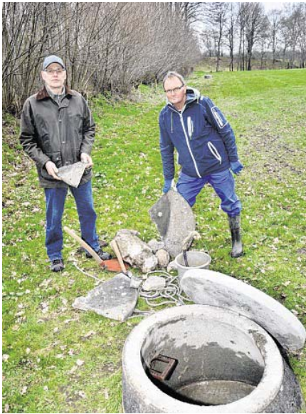
Offensichtlich mutwillig zerstört wurden die Kanaldeckel, deren Trümmerstücke mitsamt Feldsteinen, Mauerresten und einem Betonfundament vier Meter tief im Schacht versenkt wurden. Hans Mau (l) und Rolf Peters überprüfen seit 25 Jahren die Verbandsleitungen. Solche eine Zerstörung haben sie noch nicht erlebt. Foto: Weiss
